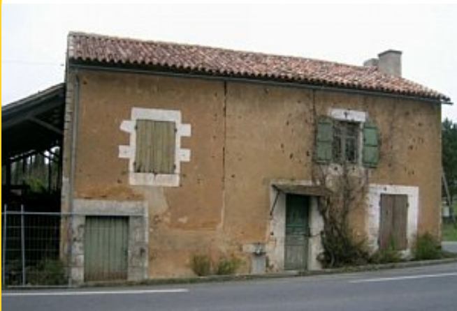
Ferme à bâtiments jointifs, au bord de la R. N. 11. © Région Poitou-Charentes - CAP / G. Renaud, 2005.
